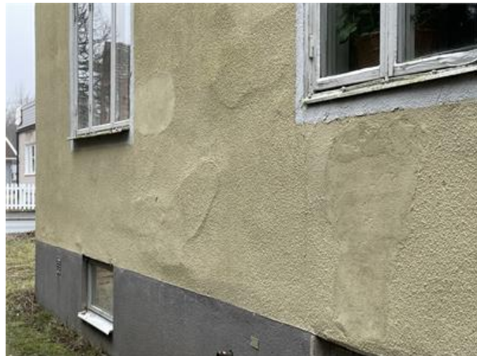
Fasad har lagningar, putssläpp och bom.
