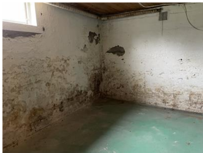
Viss fuktinträngning källare.
