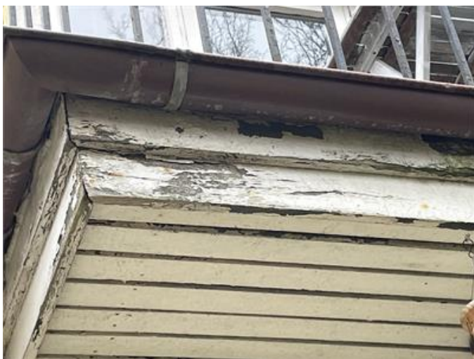
Balkong har renoveringsbehov.
