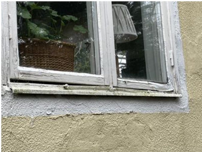
Fönsterpartier med renoveringsbehov/behov av byte.
