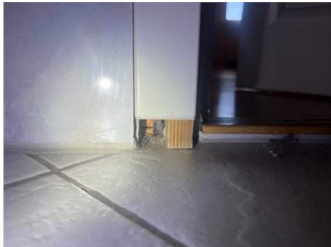
Vid dörrfoder noterades inget uppviktt av tätskikt, tätning rekommenderas.
