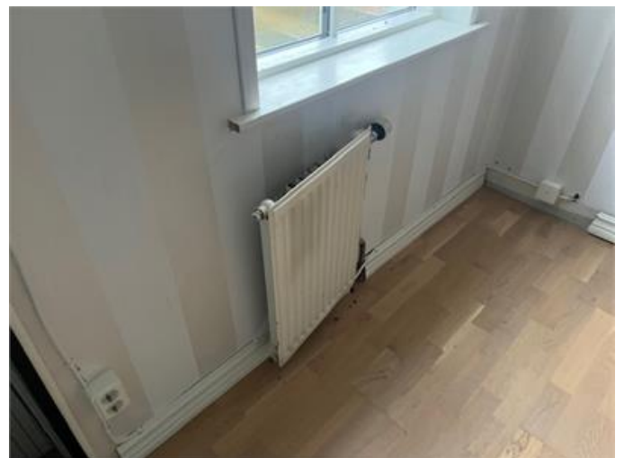
Två radiatorer noterades som lossnat från fäste i väggen med risk att rör går av. Förbättra upphängningen samt kontrollera övriga radiatorer i förebyggande syfte.
