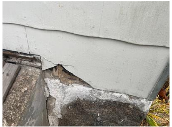
Enstaka trasig fasadskiva av eternit noterades, vid åtgärd notera att eternit kan innehålla asbest. Vid källartrappan bör tätning utföras, risk för fuktskador
