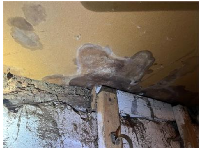
Missfärgning noterades i tak i källaren under kök, hög fukt indikerades från källaren. Orsak om omfattning bör undersökas och åtgärdas
