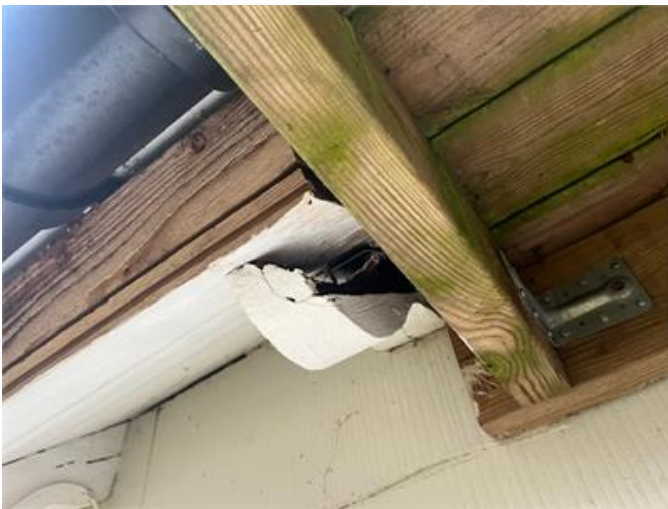
Äldre rötskada noterades i taksparre vid entrén, ingen förhöjd fukt uppmättes vid besiktningen, bedöms uppkommit innan taket renoverades
