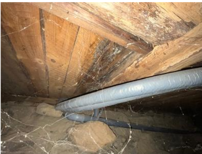
Lokal missfärgning/påväxt noterades i krypgrunden, ingen förhöjd fukt uppmättes vid besiktningen.
